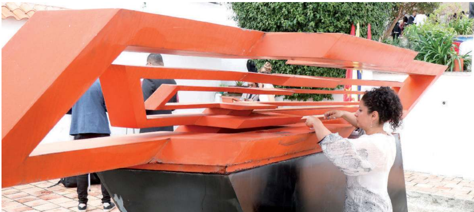
La maestra María Carolina Leiva haciendo el diagnóstico de la obra Horizontal como el Mar, ubicada en el campus La Casona, para la posterior restauración.
